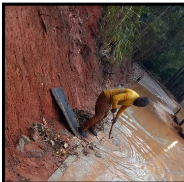
Figura 06 - Entupimentos de Boca de Lobo
