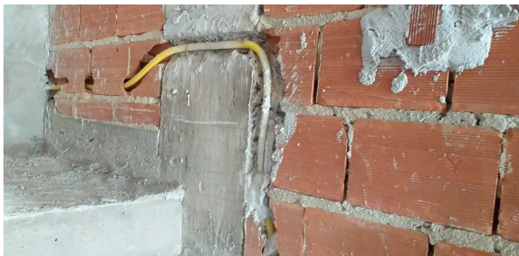
Figura 18: Conflito entre projeto elétrico e estrutural.
