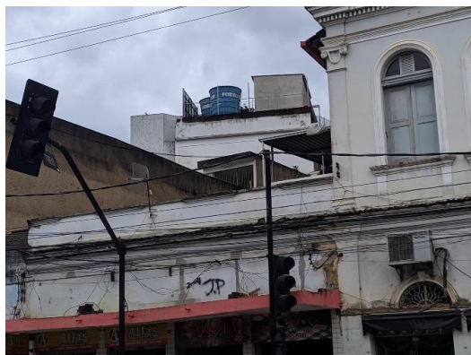
Figura 2 – Degradação do revestimento.
