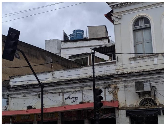
Figura 2 – Degradação do revestimento.
